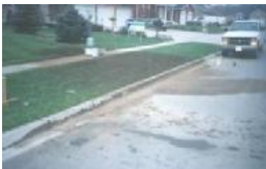
Izquierda – mancha de aceite antes del tratamiento
